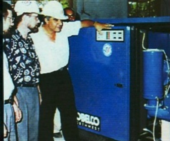
مهندسو مشروع ترشيد الطاقة وحماية البيئة ويقومون بفحص ضواغط الهواء الحديثة وتمتاز هذه الضواغط بصغر الحجم وتجميعها مع كافة مستلزماتها داخل حاوية واحدة
