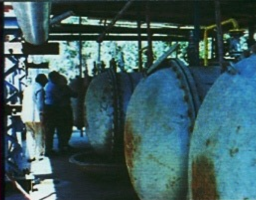
كانت مكونات النظام القديم للتبريد تشغيل مساحة كبيرة مما استلزم تركيب شبكة مواسير ممتدة لمسافات طويلة
